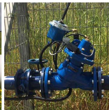
CONTROL DE CAUDAL Y PRESIÓN
