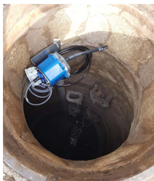
CONTROL DEL NIVEL DE LA FOSA DE AGUAS RESIDUALES
